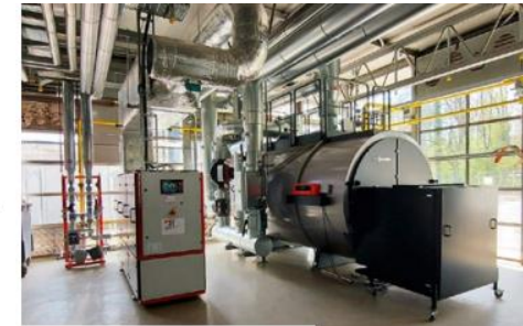
Heizzentrale Bruchsal Südstadt
